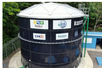
Tanques de agua potable
