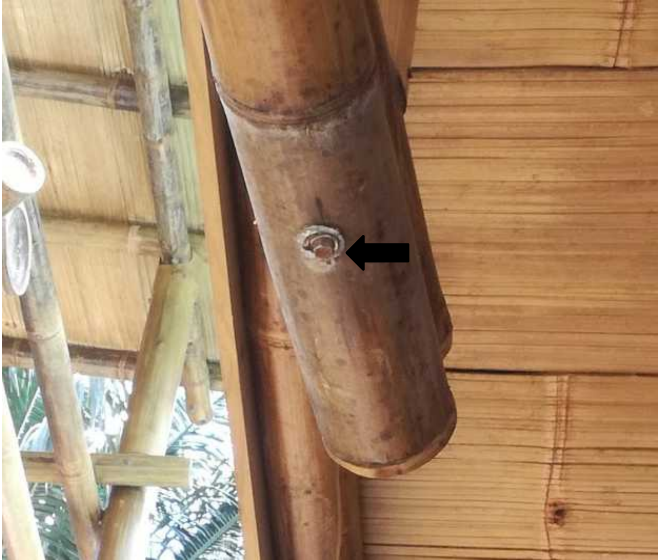
Imagen 6. Tornillos oxidados en la estructura de la escuela
