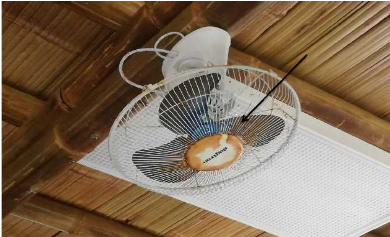
Imagen 1. Abanicos de techo oxidados
