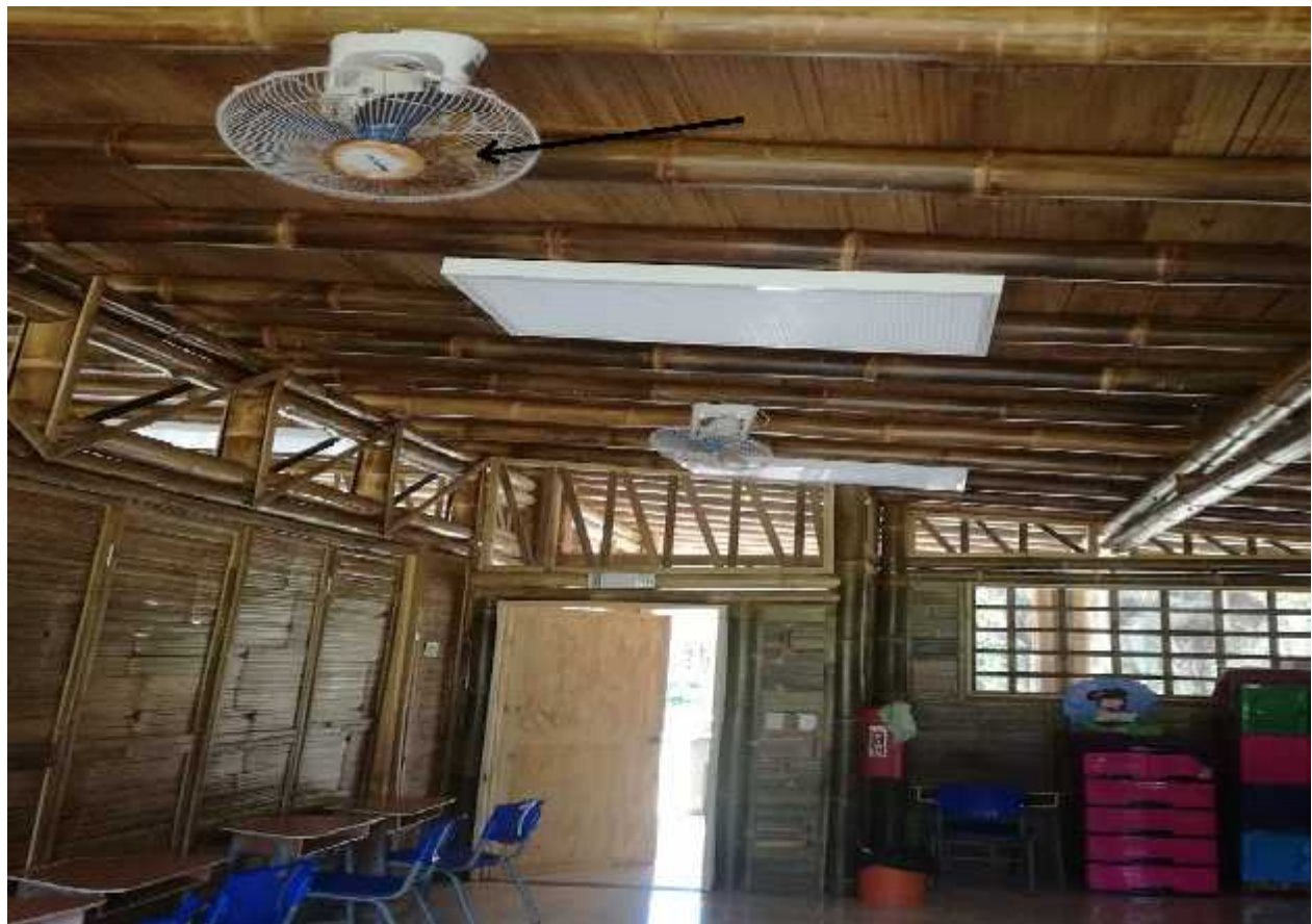
Imagen 2. Abanicos en techo de aulas con oxido.
